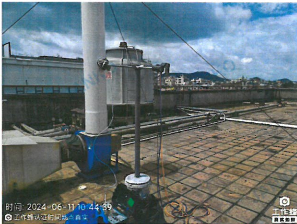
有机废气排放口 02
